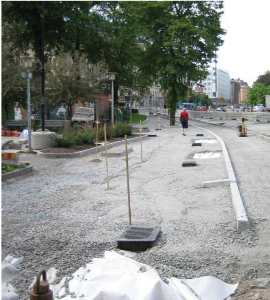
Luft- und Abwasserbrunnen Typ Clarova, hier mit Abdeckungen aus vergütetem Eisen, und komprimierte Tragschicht. Die Strecke enthält sowohl neue Pflanzgruben als auch Pflanzgrubenrenovierungen für vorhandene Strassenbäume.
