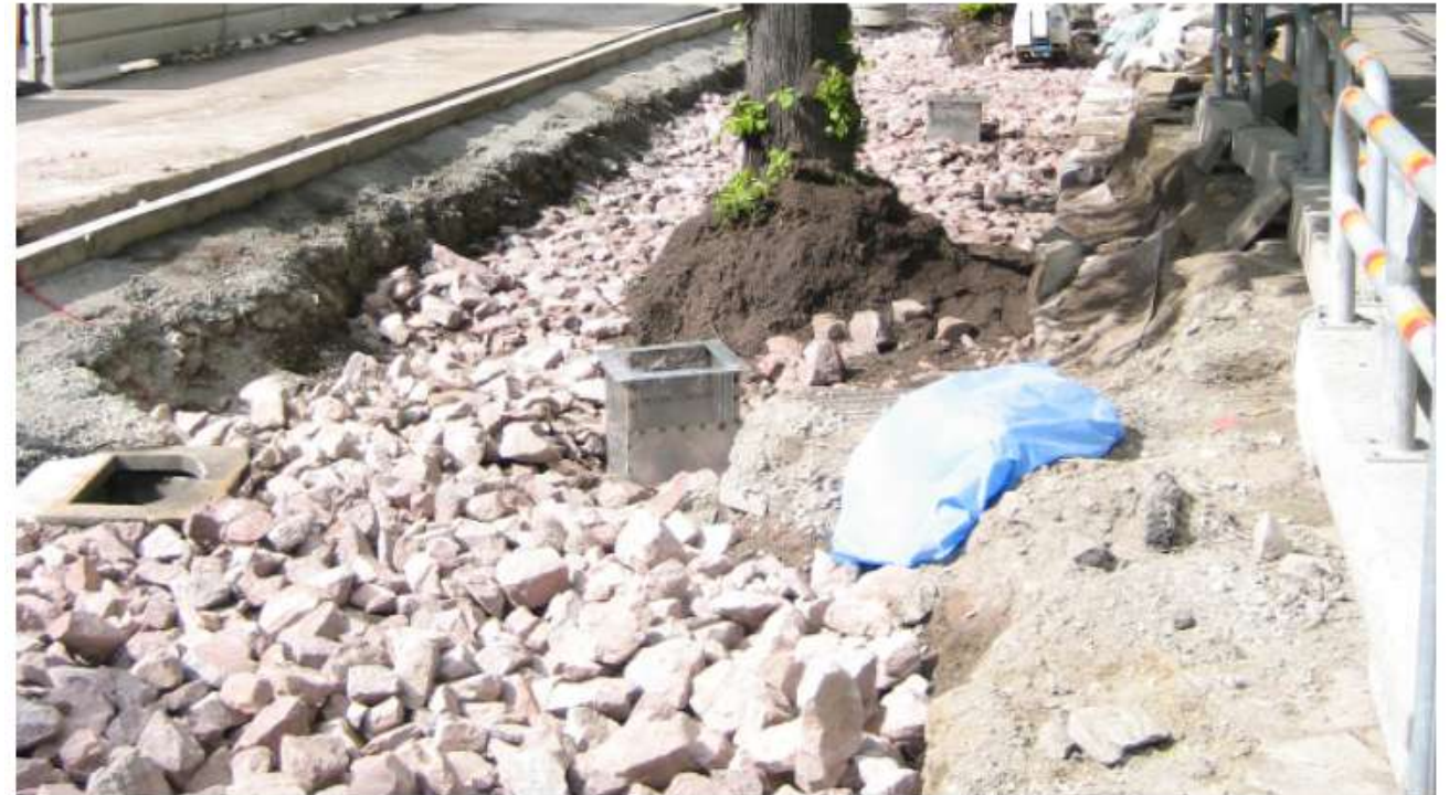
Vorhandene Strassenbäume nach einer Schachtarbeit. Man hat angefangen, Skelettscherben auszulegen und Luft- und Abwasserbrunnen wurden direkt auf die Scherben gesetzt. (Foto: Björn Embrém)
