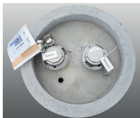
Füll- und Absaugstutzen Pelletspeicher
