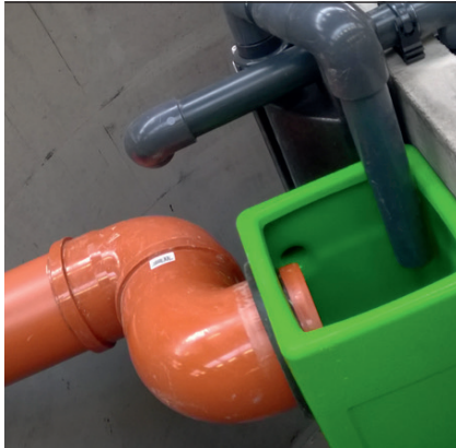
Centrale de commutation automatique (= la tête de l'installation avec d-pac®)
