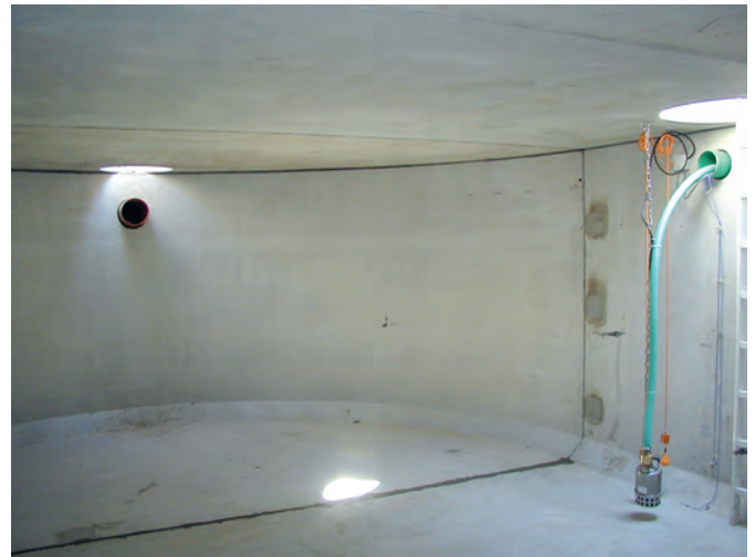
Bild 4. Betriebshof Regensburger kommunaler Fahrzeugpark. Unterirdischer Regenspeicher aus Betonfertigteilen mit 66 m 3 Fassungsvermögen. Links Überlauf, rechts Zulauf und Unterwassermotorpumpe mit Entnahmeleitung. (Foto: RFG)
