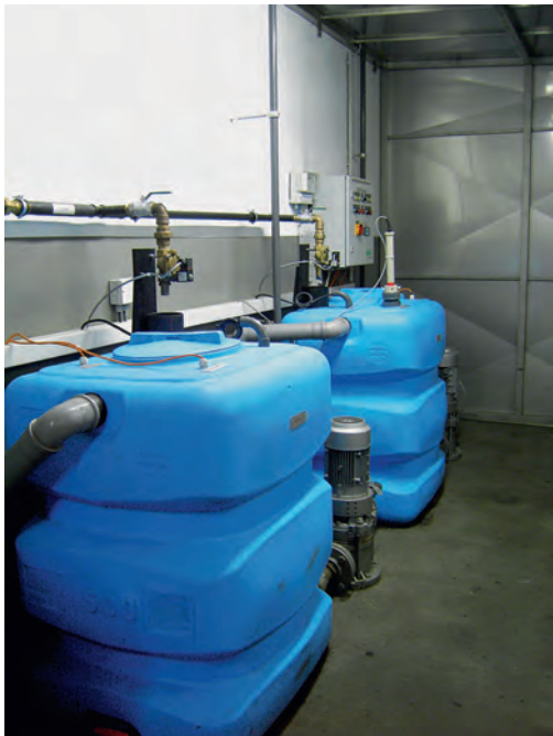
Bild 5. Betriebshof Regensburger kommunaler Fahrzeugpark. Oberirdische Vorlagebehälter für das gereinigte Kreislaufwasser und das Regenwasser. Von hier aus wird die Waschstraße für Busse versorgt. (Grafik/Foto 3 und 5: Mall)
