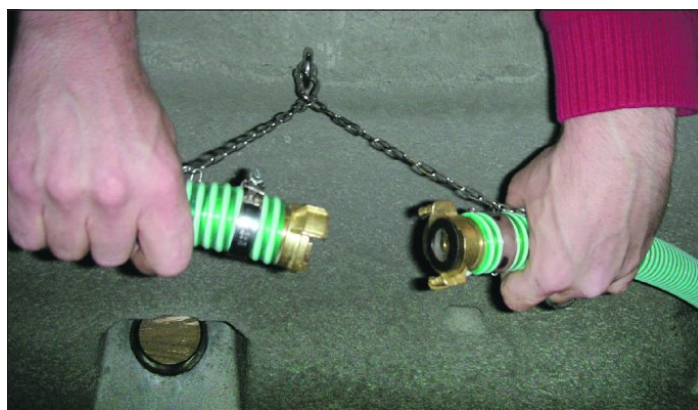
Flexibler Druckschlauch in der Zisterne mit Schnellkupplung, die für die Frostsicherheit mit einem Handgriff getrennt wird.
