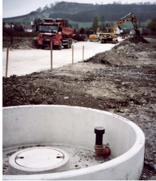
Regenspeicher System Terra vor der Bepflanzung
