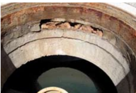
Undichter Schachtaufbau (Foto: Mall GmbH)
